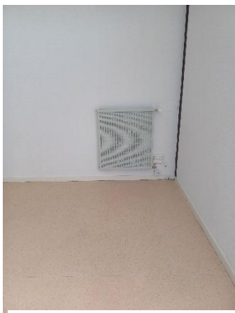
Ancien radiateur de la résidence Gluck PATRIMOINE
